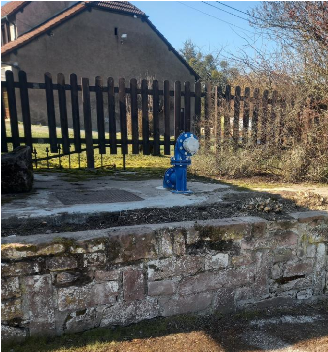
Raccord pompier citerne incendie rue du Moulin Brisse.
