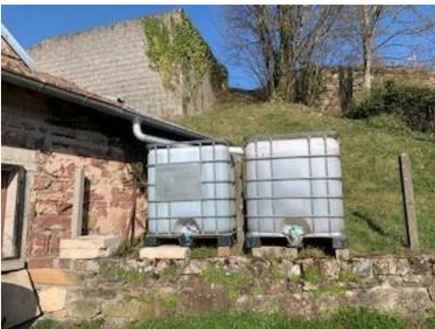
Citernes récupération eaux de pluie.
